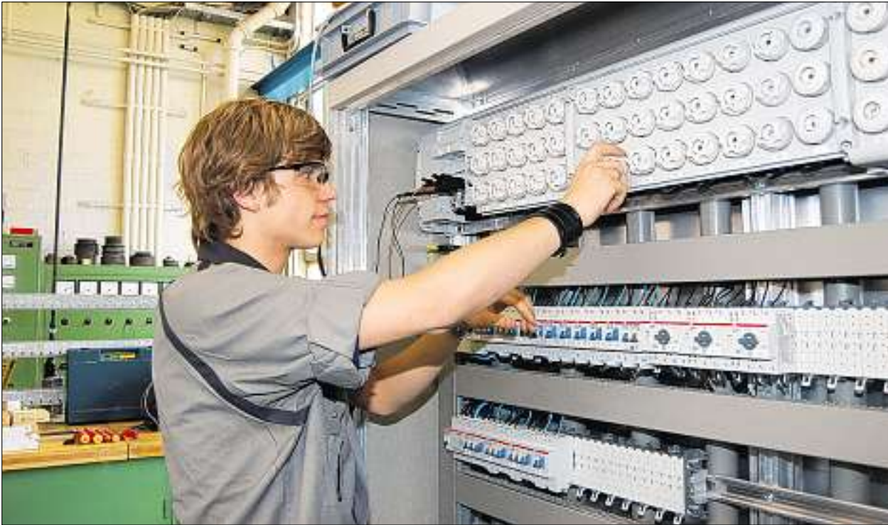
Manuel Willi beim Überprüfen einer Schalt- und Verteilanlage einer Polymerisationsanlage. Bilder Ladina Steinmann
